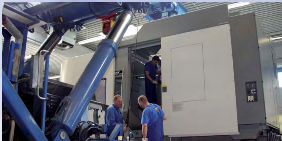
■ Präzisionsarbeit war gefordert, um das 40 Tonnen schwere Bearbeitungszentrum in der Fertigung in die richtige Position zu bringen
